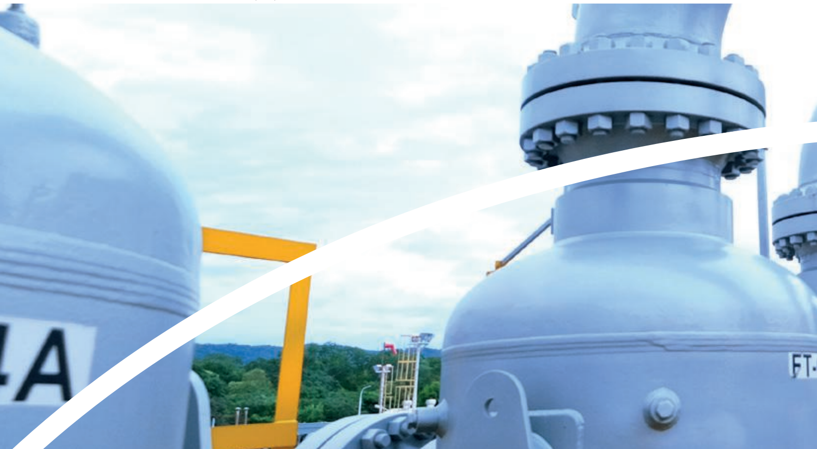
ESTACIÓN DE COMPRESIÓN VILLA MONTES (ECV)
