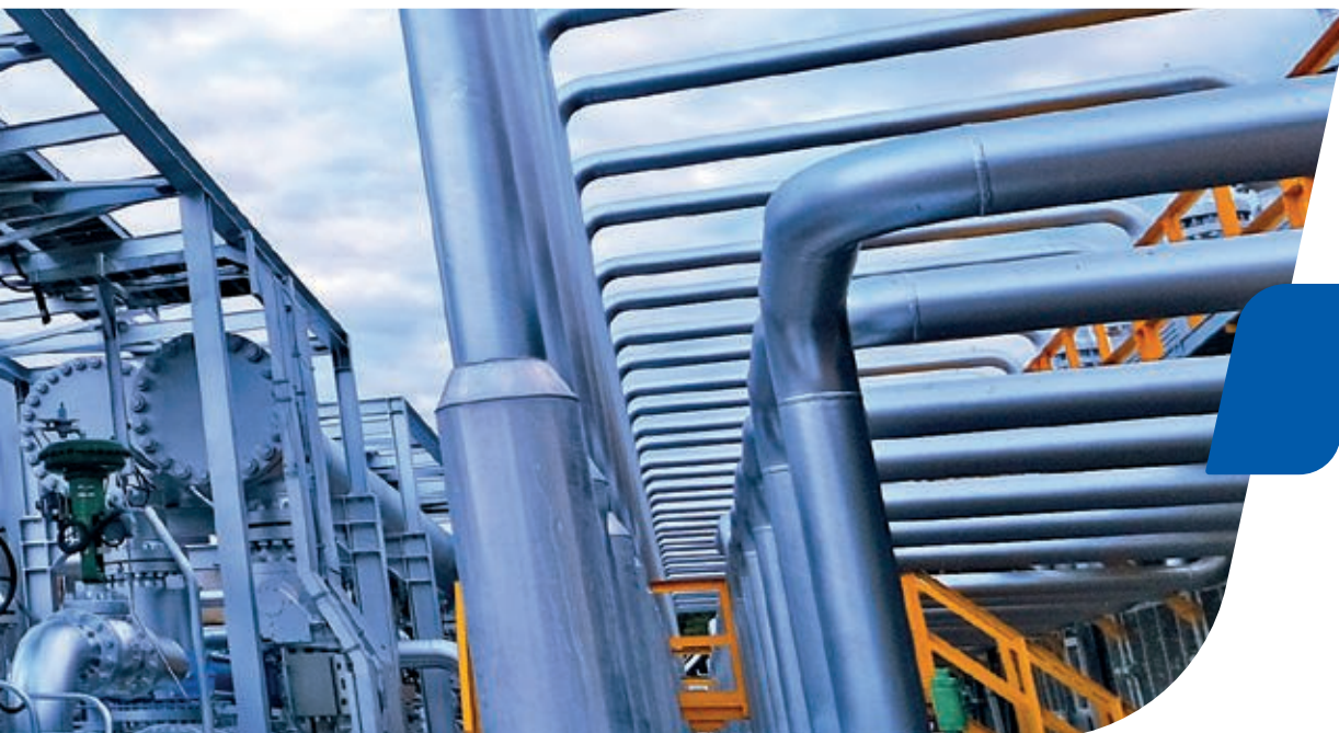
ESTACIÓN DE COMPRESIÓN VILLA MONTES (ECV)
