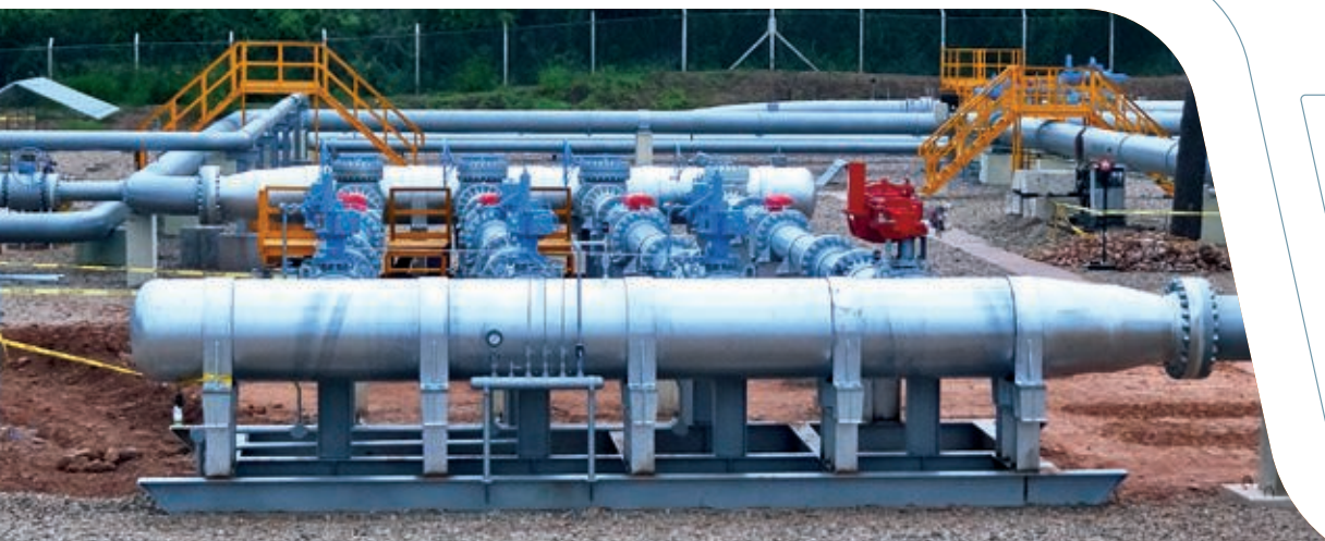
ESTACIÓN DE COMPRESIÓN VILLA MONTES (ECV)
