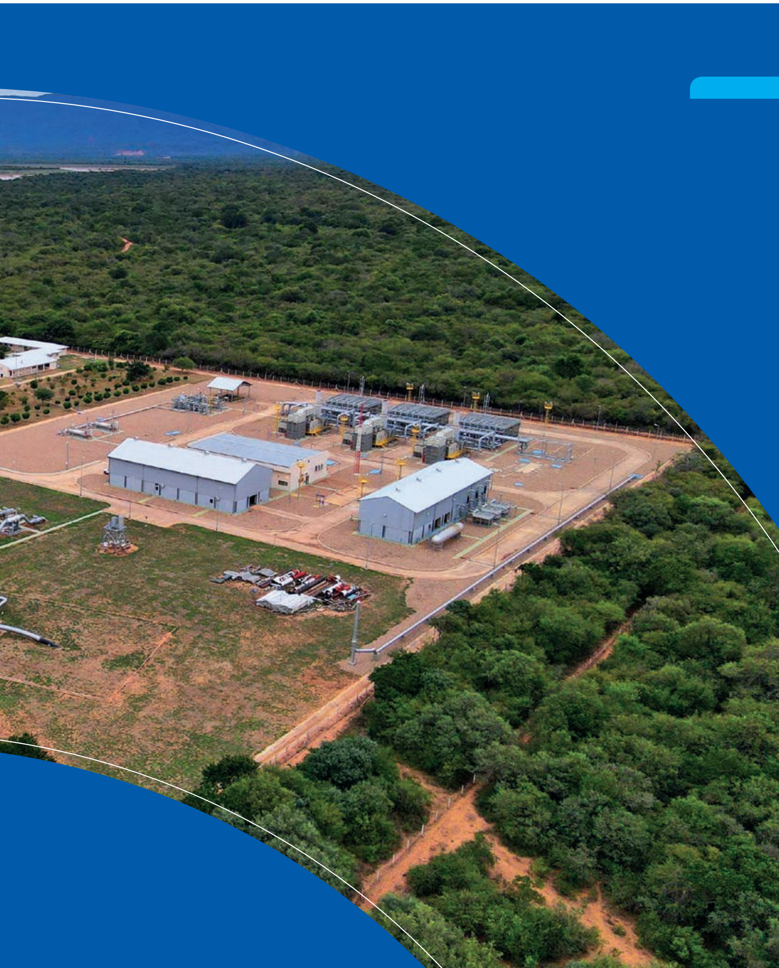
ESTACIÓN DE COMPRESIÓN VILLA MONTES (ECV)
